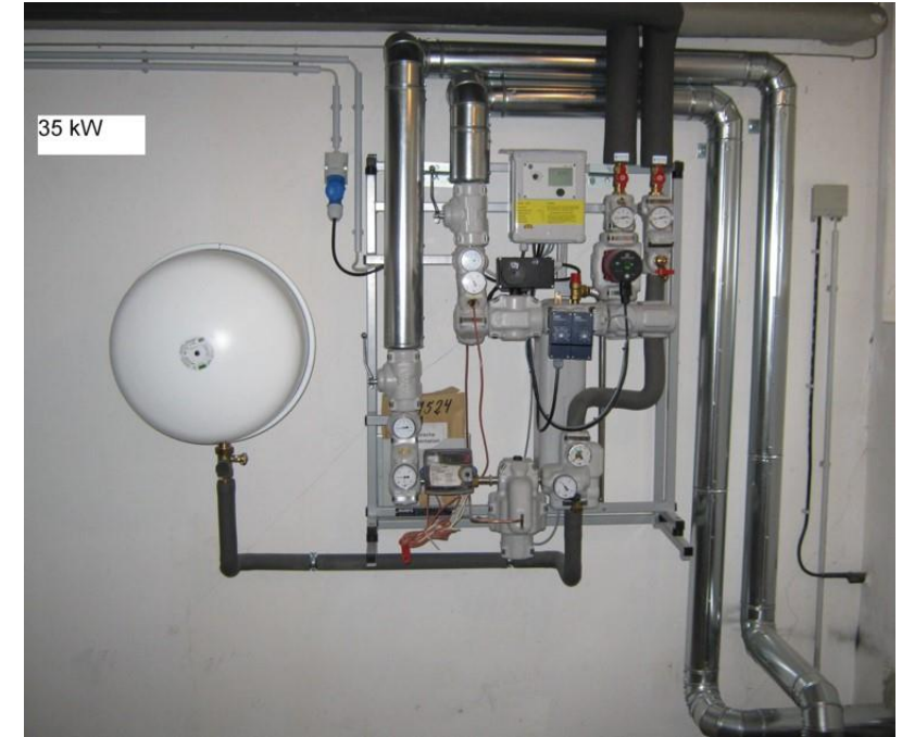
Verwaltungsgebäude mit einem Heizkreis
