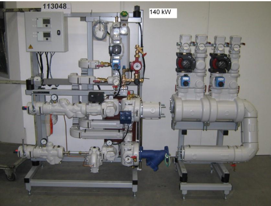
Mehrfamilienhaus mit Brauchwassererwärmung und zwei Heizkreisen
